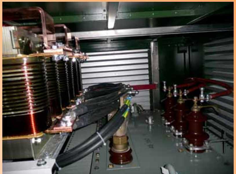
Traforaum mit 1600 kVA-Transformator und Tonfrequenzsperre
